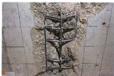
側壁外側破壊部
